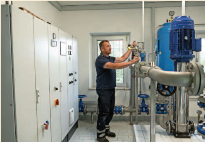
Wassermeister Jürgen Felix kontrolliert die Trinkwasserpumpanlage in Steigen.
